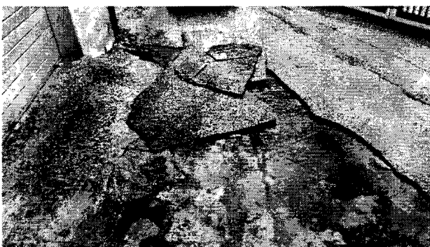
Distacco asfalto strada interna
